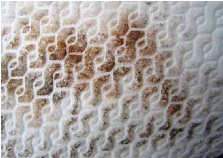
Wischprobe mit alkoholfeuchtem Tuch vor einem Derouging.
